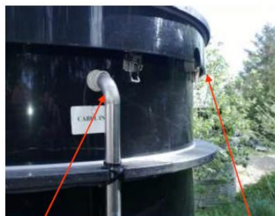
Kabelgennemføring til teknikkasse
